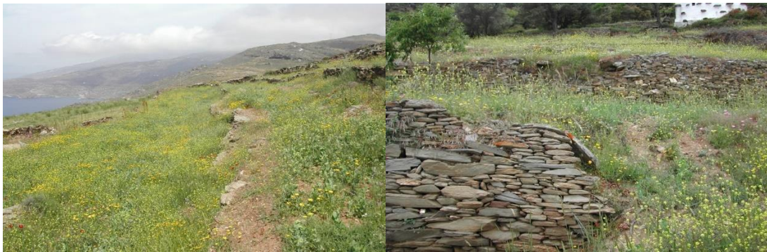
Εικόνα 9: Παραδείγματα μερικής κατάρρευσης των ξερολιθιών (αναβαθμίδων) στην Άνδρο.
